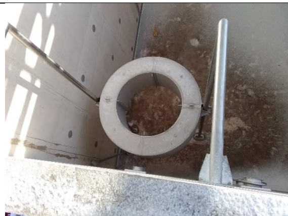
Pelles aquadécants installées dans les casiers
