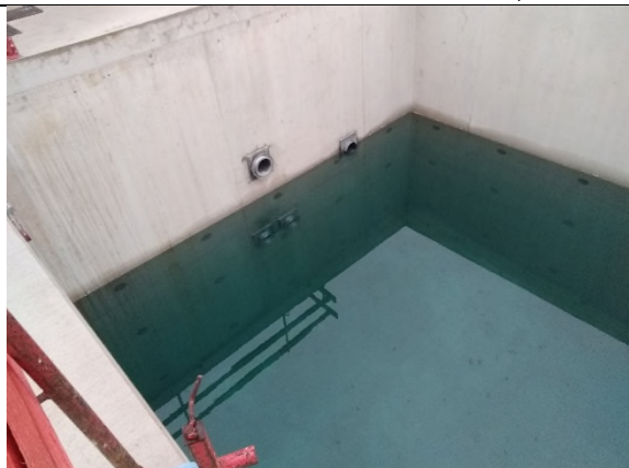
Cellule SBR en eau
