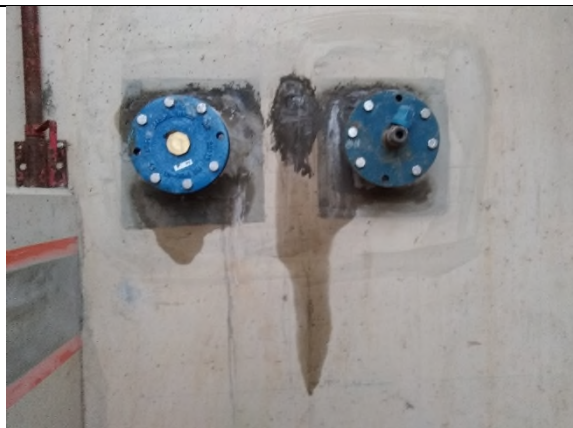
Traces humides au niveau du mur de refend (face avant)
