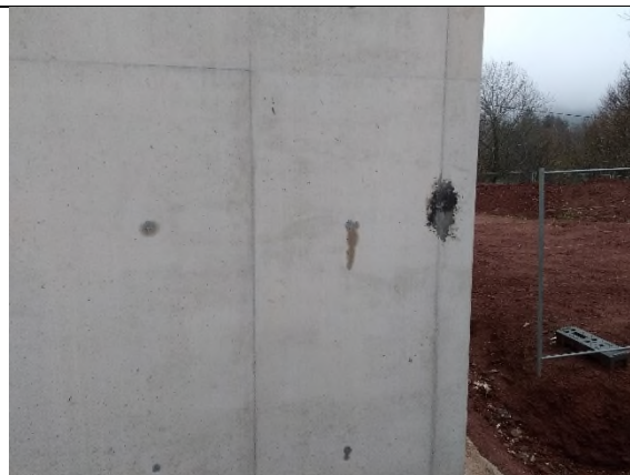
Traces humides au niveau des trous de tige (face arrière)
