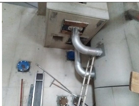
Equipement extérieur du DDC
