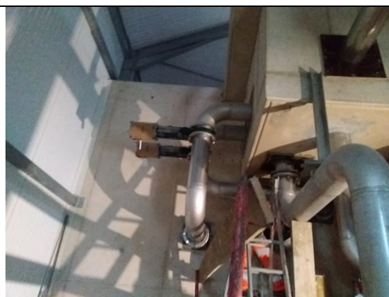
Equipement extérieur du regard de répartition
