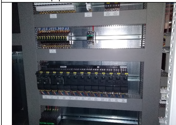
Unités de contrôles des disjoncteurs manquants
