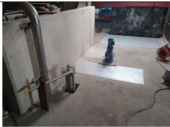
Equipement du dégrilleur
