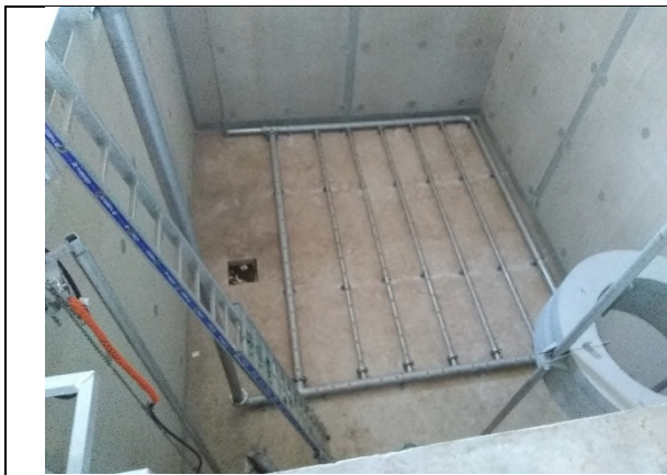
Equipement des bassins SBR
