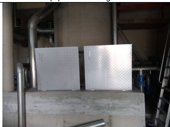
Trappes d'accès aux fosses à déposer et à remonter pour une manipulation plus aisée
