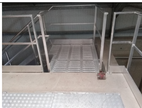
Escalier posé (dernier palier à revoir)
